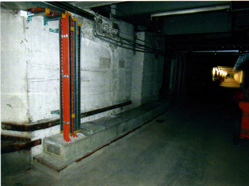
Teil der E30 Funktionserhaltungszuleitungen zu den Längsbahnsteigen
